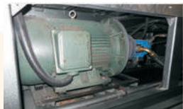
Montaj Öncesi Standart Motor ve Pompa Before Revision
