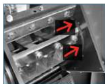
Dischi rotanti solidali al rotore e anelli di contenimento.
